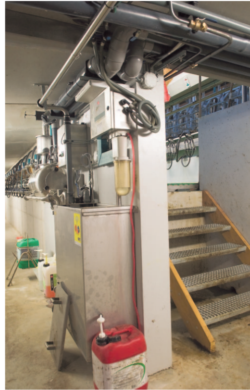
De subway (links) herbergt de apparatuur van de melkstal.
